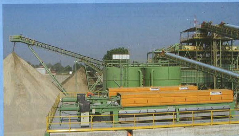
IMPIANTO COMPLETO DEPURAZIONE ACQUE E TRATTAMENTO FANGHI
