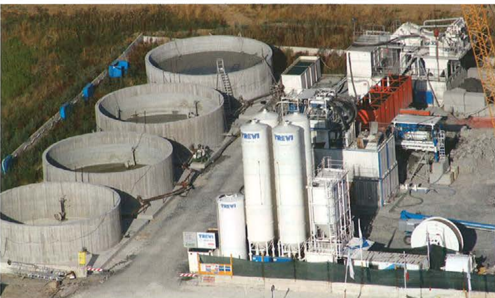
Impianto di trattamento reflui di perforazione – Campo Prove Trevi – Gualdo (FC)
